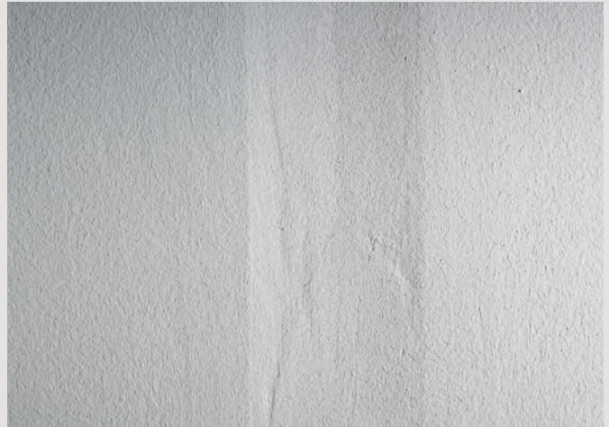
Vertieft gespachtelte Fuge bei starkem Streiflicht
