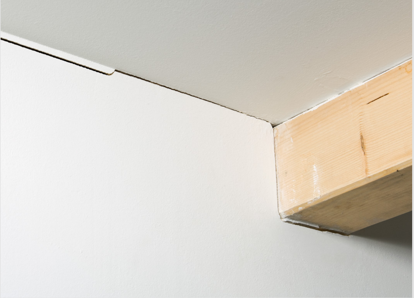
Überspringender Riss aufgrund fehlender Bauteiltrennung
