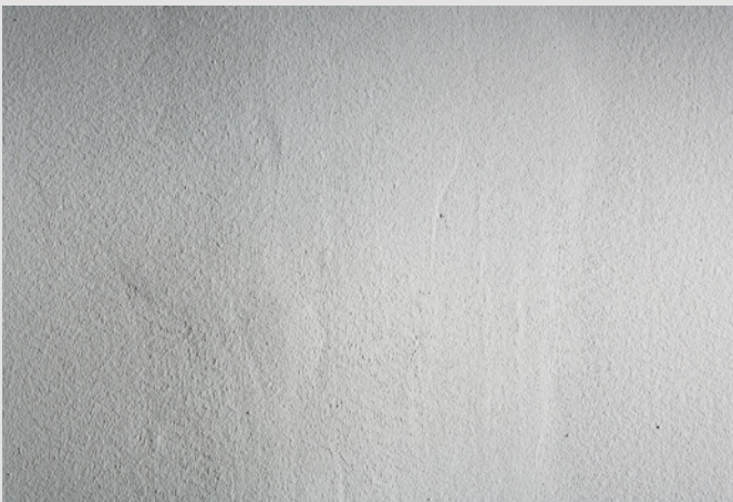
Erhöht gespachtelte Fuge bei wenig Streiflicht
