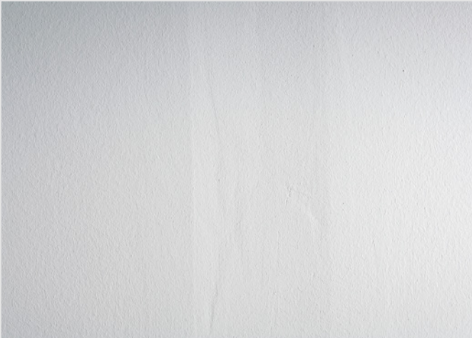
Vertieft gespachtelte Fuge bei wenig Streiflicht
