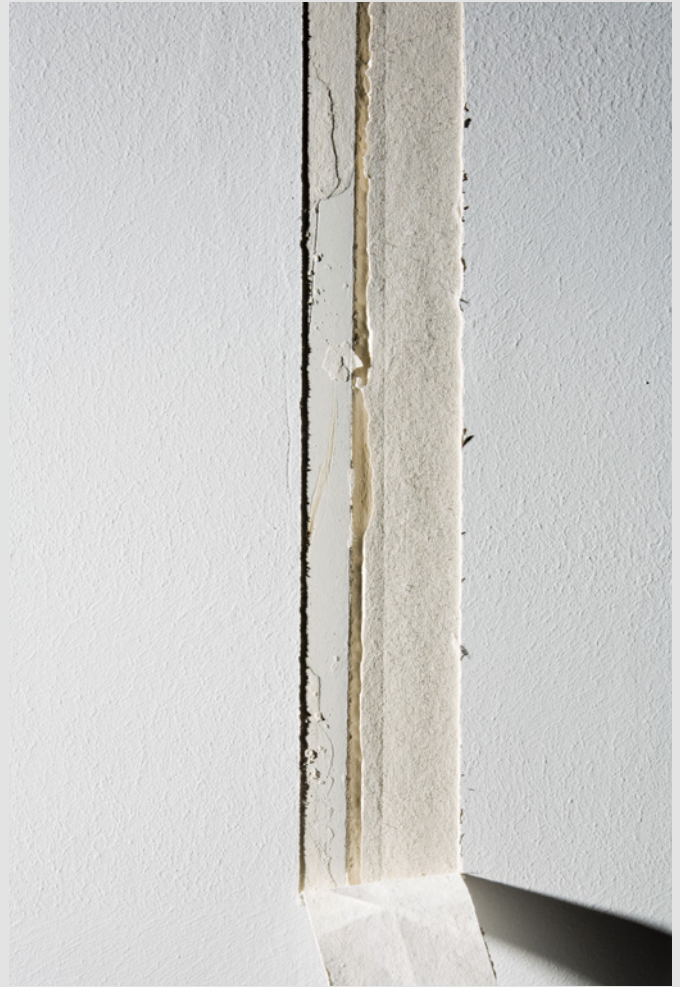
Ursache: zu wenig Spachtelmaterial unter dem Fugendeckstreifen auf der SK-Seite (links der Fugenmitte)
