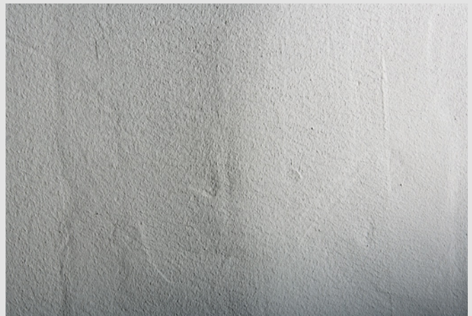
Erhöht gespachtelte Fuge bei viel Streiflicht
